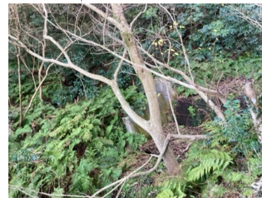
写真 16 倒木で埋まった砂防堰堤
